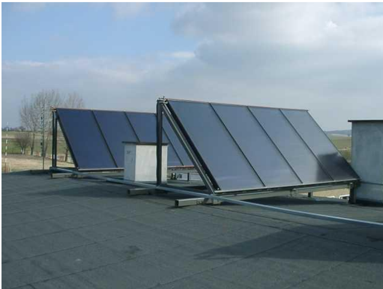
Rysunek 2-19 Instalacja kolektorów słonecznych na terenie Domu Dziecka w Pieszcach – filia w Piławie Górnjej
