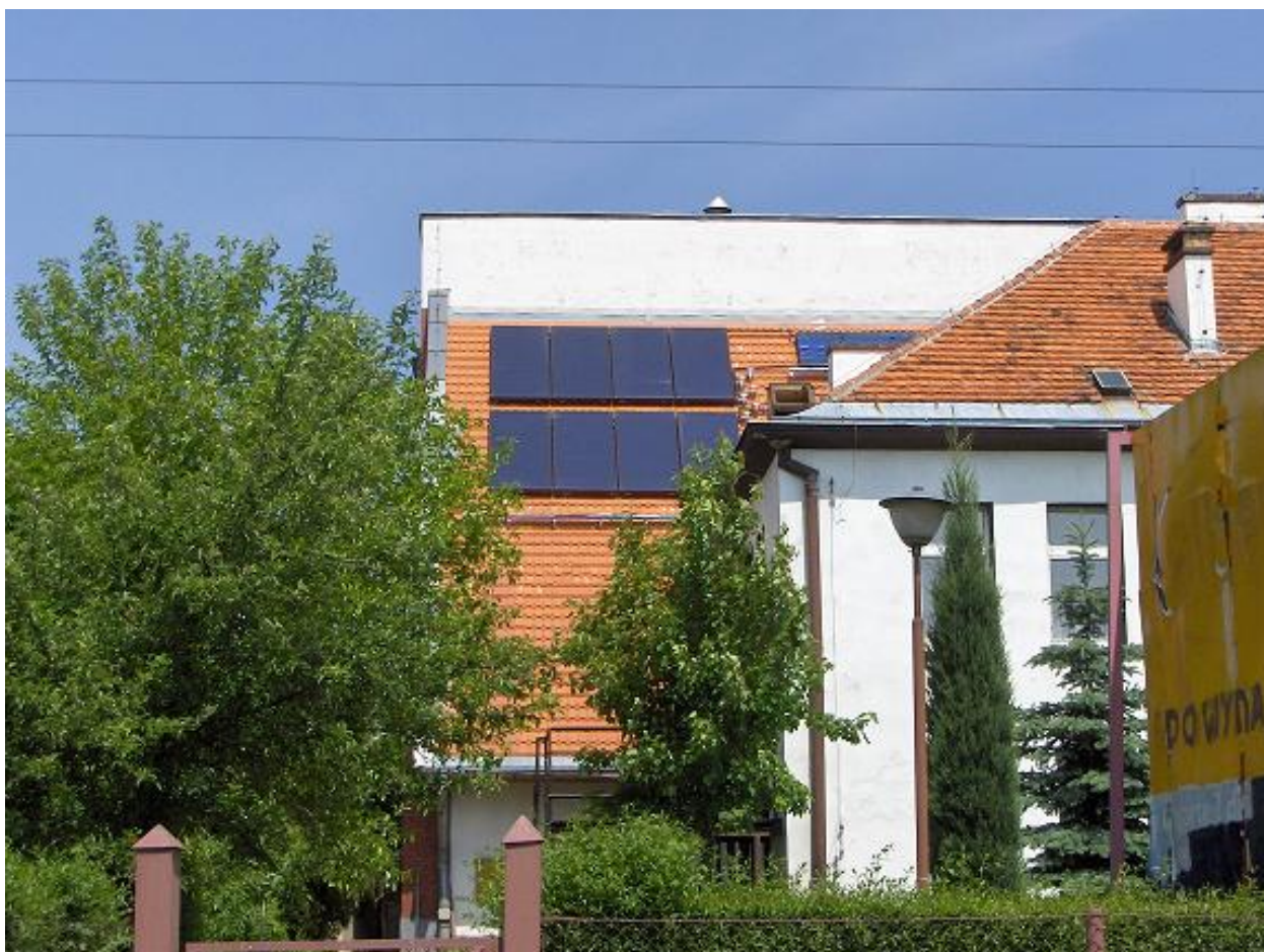
Rysunek 2-18 Instalacja kolektorów słonecznych na terenie Domu Pomocy Społecznej w Bielawie
